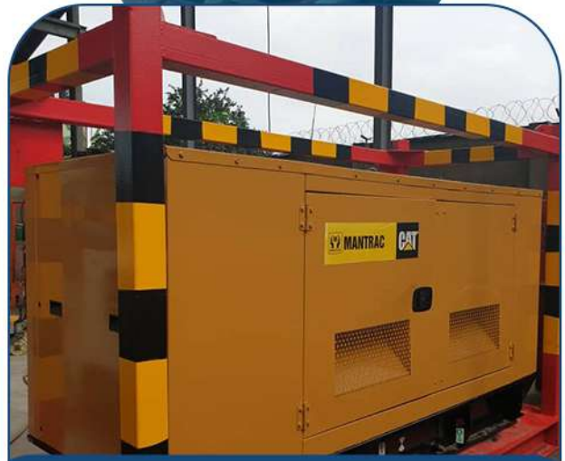
110kva Generator set
